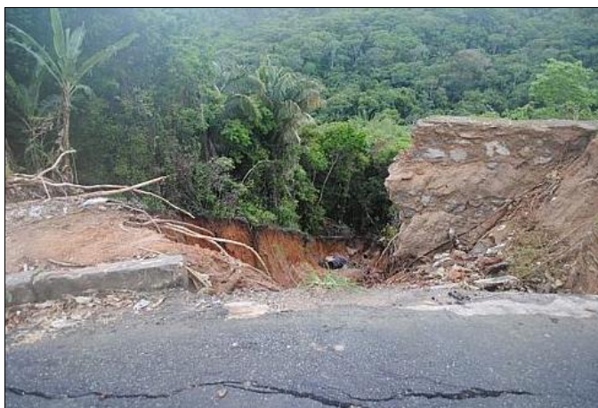
Figura 16: Petrópolis – Vista parcial de erosão por voçoroca no entorno o PqMM
